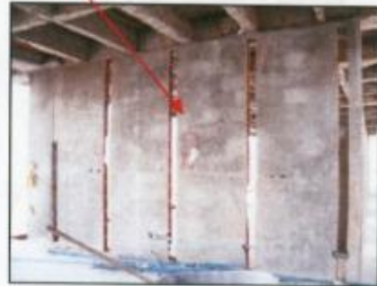
Foto: Mala calidad de los muros. Marzo 1/2007
